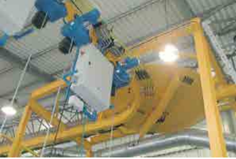
SinglePowerLine 0812 установленные в цехе гальванизации с элементами изменения направления перемещения
