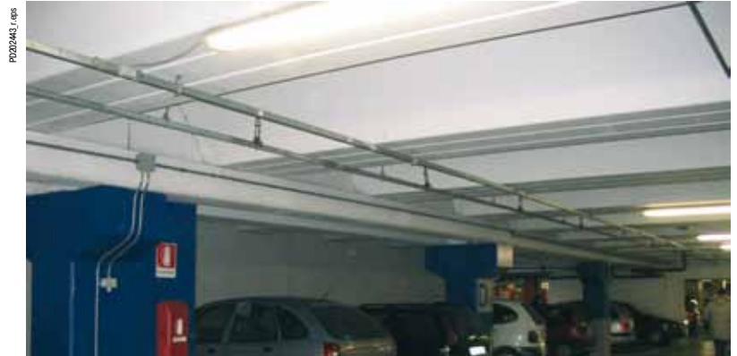
Шинопровод Canalis KVA со светильниками и спринклерами
