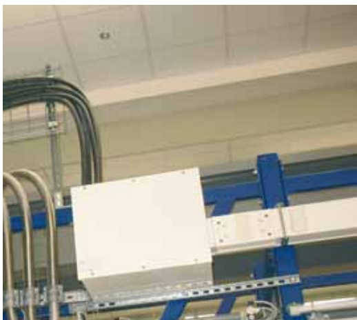
Шинопровод Canalis KS и спринклер
