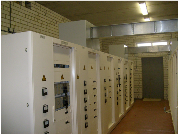
Рис.5 Присоединение горизонтальное к шкафам РУНН не типовыми присоединительными секциями. Аэробус, г. Воронеж.
