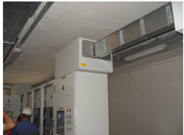
Рис.6 Присоединение горизонтальное к шкафам РУНН не типовыми присоединительными секциями. ОЭМК, г. Старый Оскол.
