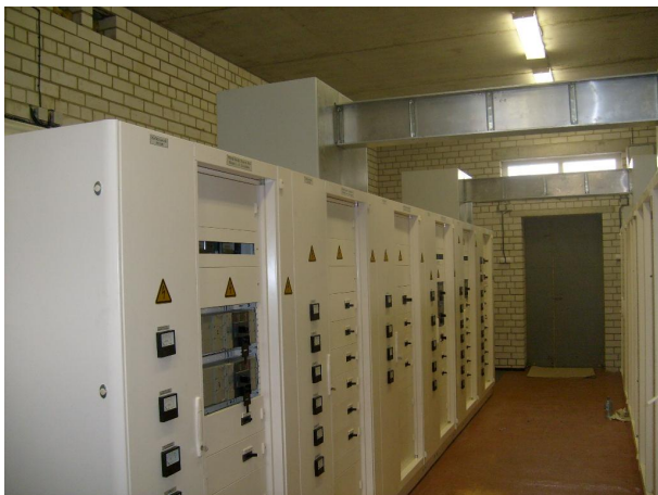
Рис.5 Присоединение горизонтальное к шкафам РУНН не типовыми присоединительными секциями. Аэробус, г. Воронеж.
