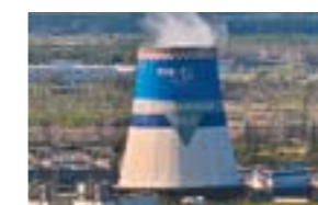
Правобережная ТЭЦ-5, г. Санкт-Петербург
