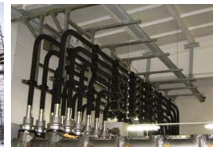
Подключение к ячейкам КРУ с изоляцией SF6 (элегаз)
