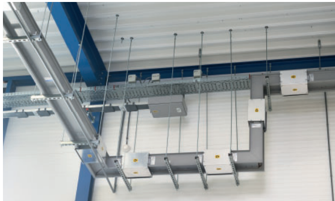
Промышленное предприятие Galvano Techniek, Хенгело, Нидерланды Шинопроводы Power Xpert® MP с медными проводниками 160 А и Power Xpert® XP с алюминиевыми проводниками 2000 А
